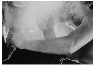
Abb.: Staubwolke beim Zerschneiden von Asbesthaltigem Material
